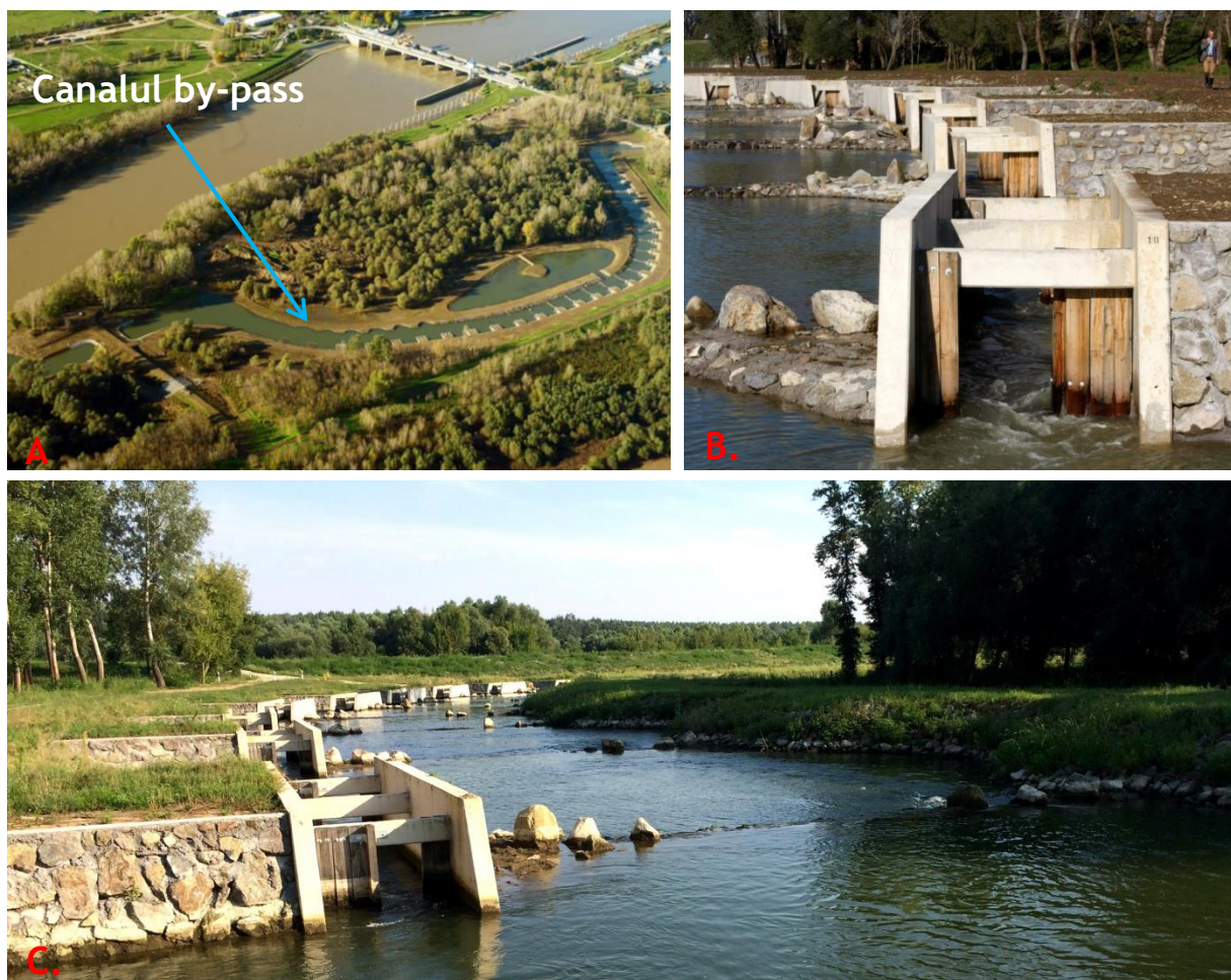
Figura nr. 6-51 A. Canalul by-pass (vedere de ansamblu); B. Scara de pești cu structuri de trecere verticale; C. Vedere de ansamblu a zonei din amonte a scării de pești (sursa: Tünde, 2015)
